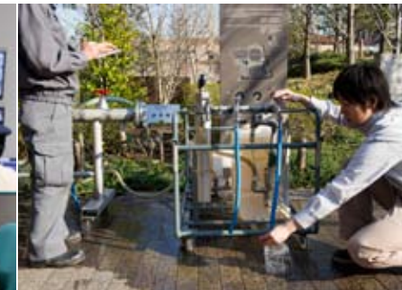
生活用水のために、MORI LIVINGのレジデンスに設置されている災害用井戸。（*）
